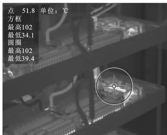
图1 工程现场监测的发热位置
